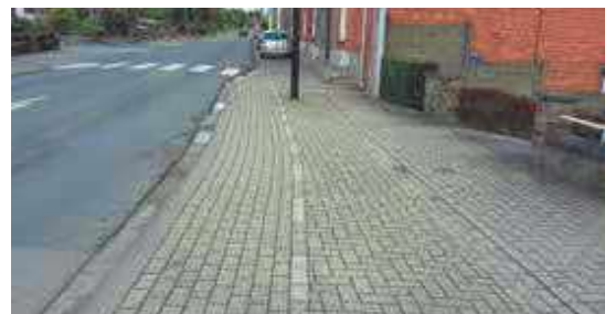
Marquage quasi-inexistant sur la chaussée d'Ophain.
